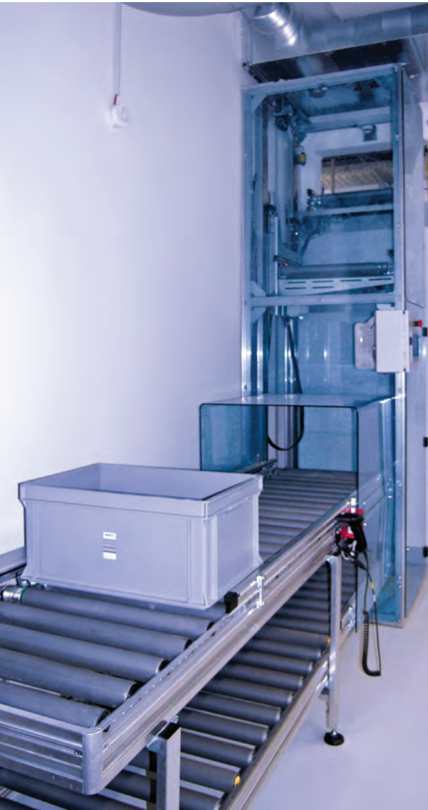
Écoulement système de transport à caissons
